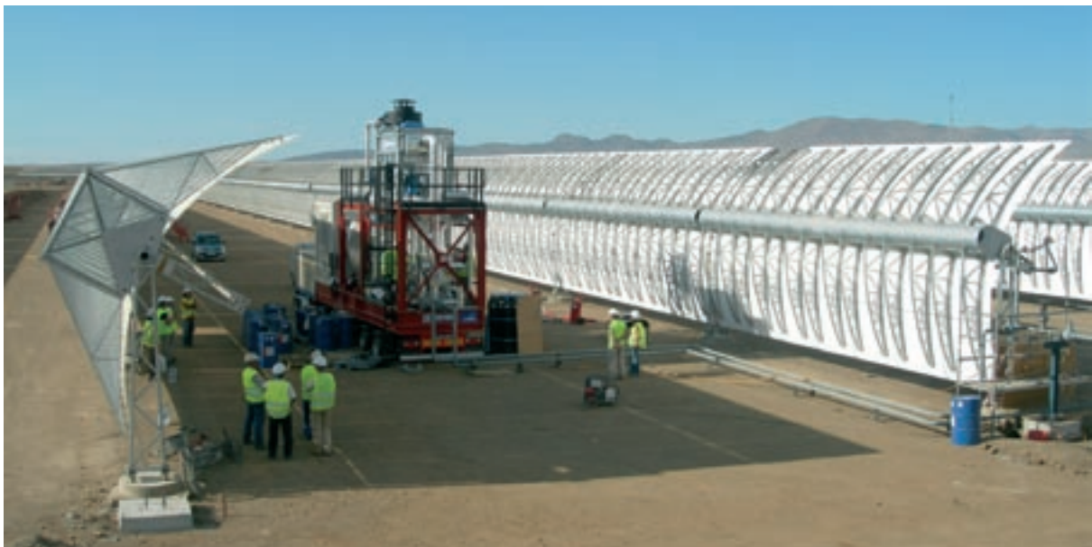
Instalación de lazos de colectores con el sistema SENERtrough en la planta solar de Andasol 1.
