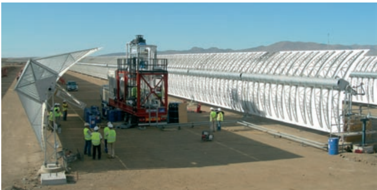
Instalación de lazos de colectores con el sistema SENERtrough en la planta solar de Andasol 1.
